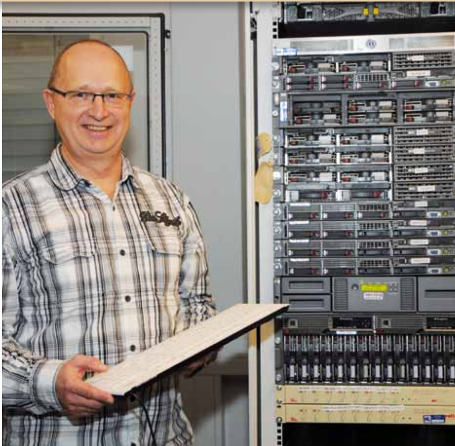
... und gibt einen Einblick in den Serverraum.
